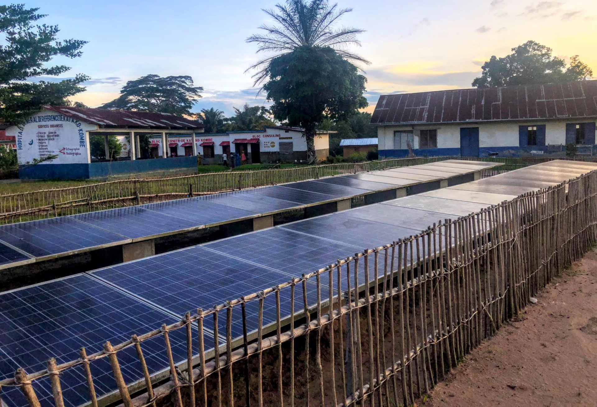
2019: uitbreiding zonnepanelen voor het ganze ziekenhuis
