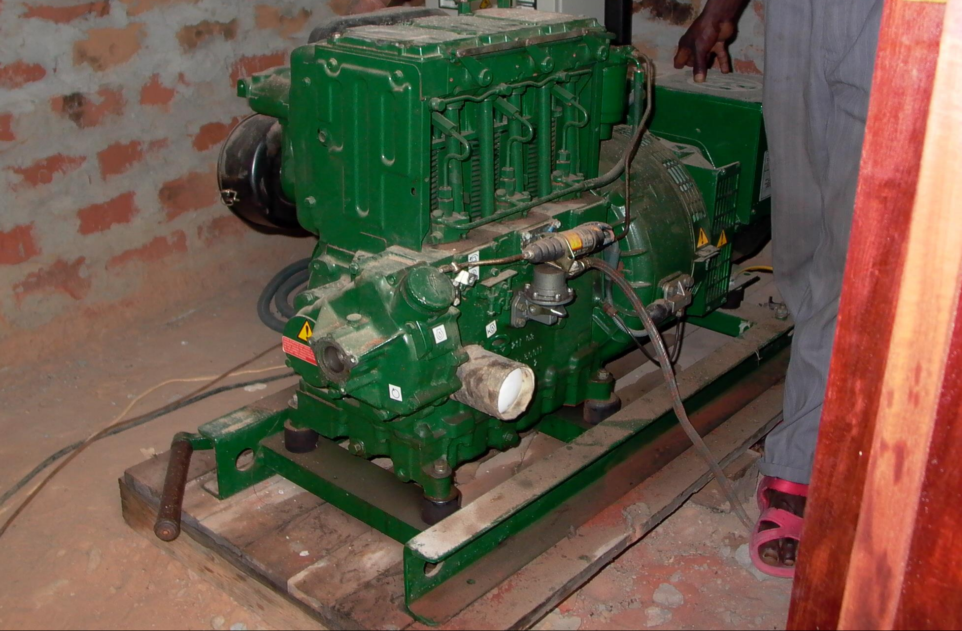
generator voor het hospitaal
